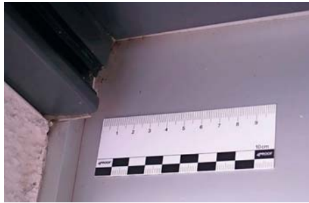
/ Die Putzüberdeckung des Bordprofils ist zu gering – Abstand der Führungsschiene zur Fensterbank zu groß.
