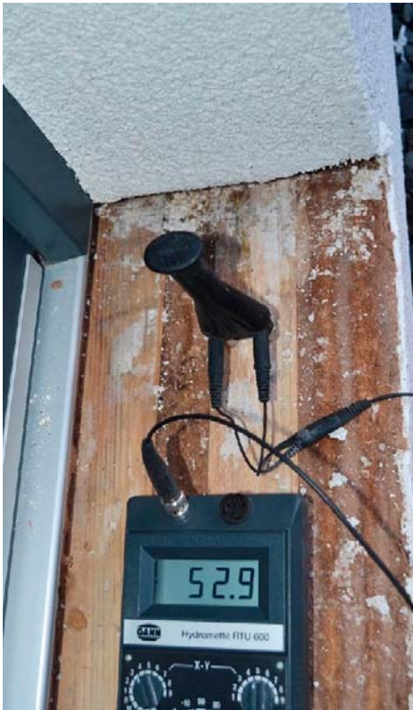
/ Demontierte Natursteinschwelle an einem Holzständerbau mit hoher Auffeuchtung im Schwellenbereich.
