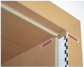
/ Zu kurz geschnittene Dichtungsprofile an den Türen verschlechtern die Schalldämmung um 8 dB(A).
