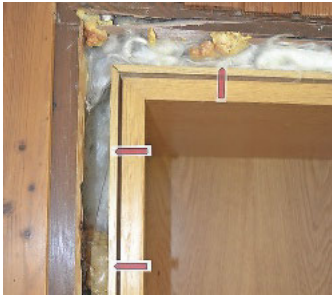
/ Tür und Zarge bieten Schallschutz, aber die Montage ist fehlerhaft.
